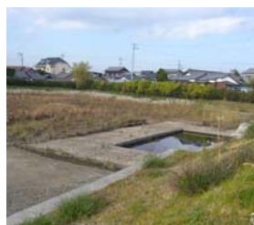
▲長田川浄化施設（安城市） 洪水時の遊水池の地下を有効利用しているよ。浄化した水を放流するときの勢いはすごいよ～。
